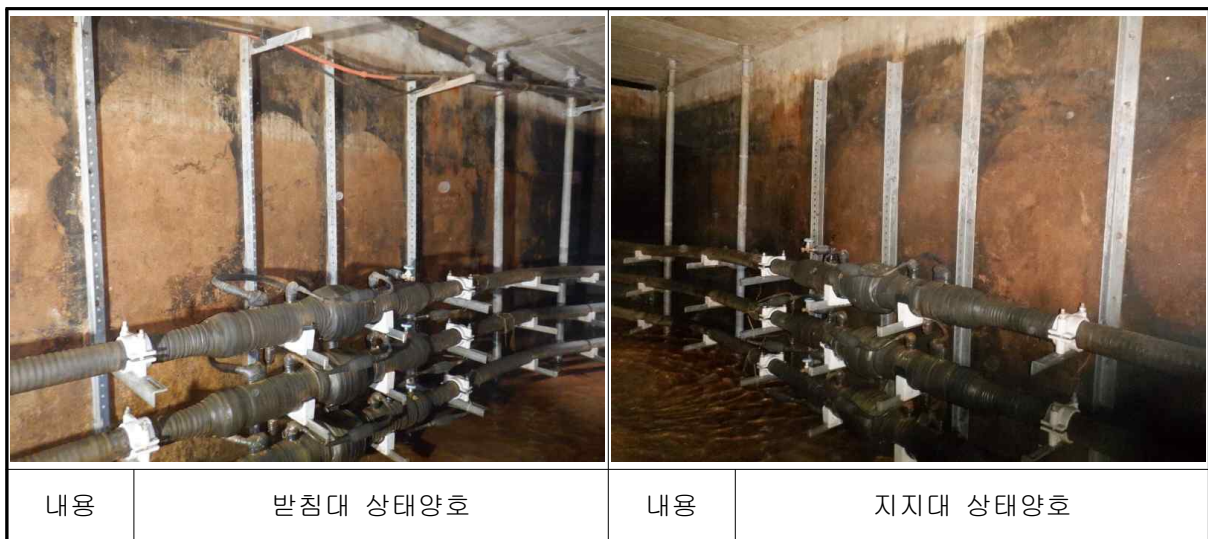
【사진 11.4】 부속 및 부대설비 현황
