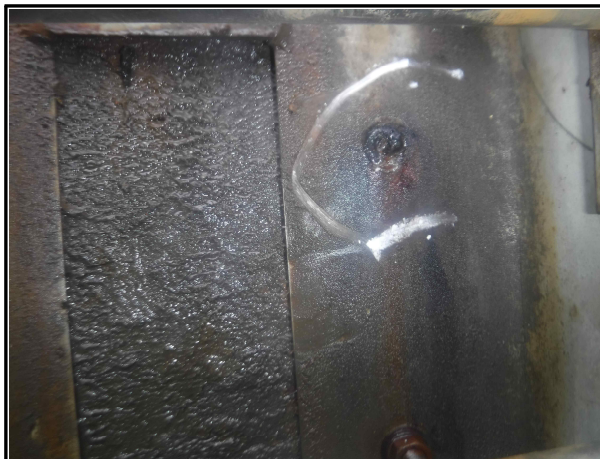
내용 추락방지시설 앵커볼트 파손
