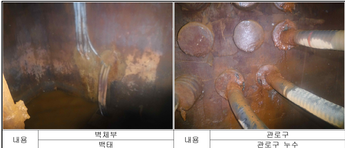
【사진 11.26】 맨홀 내부 주요 손상
