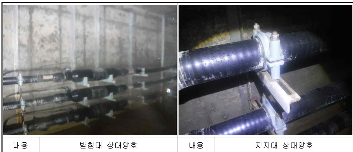
【사진 11.52】 부속 및 부대설비 현황
