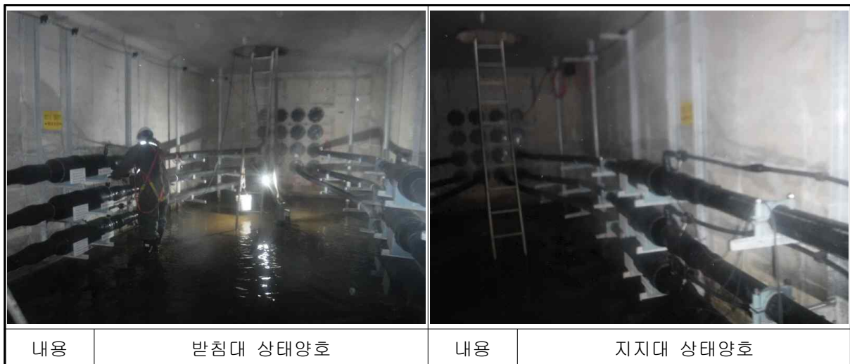
【사진 11.64】 부속 및 부대설비 현황
