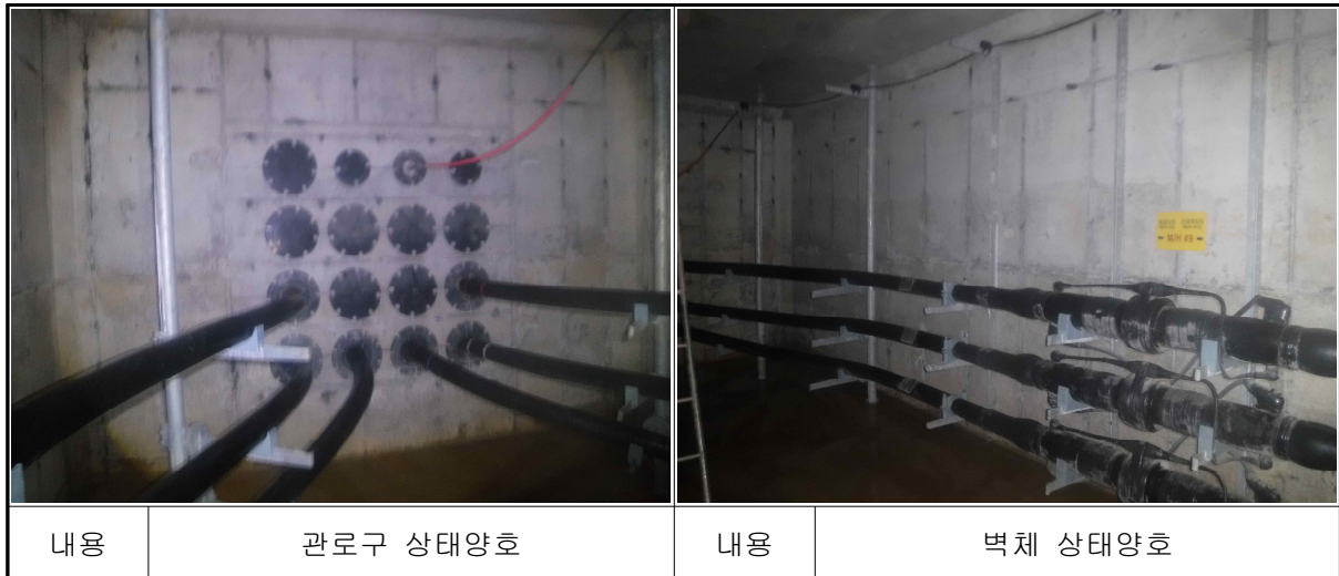
【사진 11.34】 맨홀 내부 주요 손상
