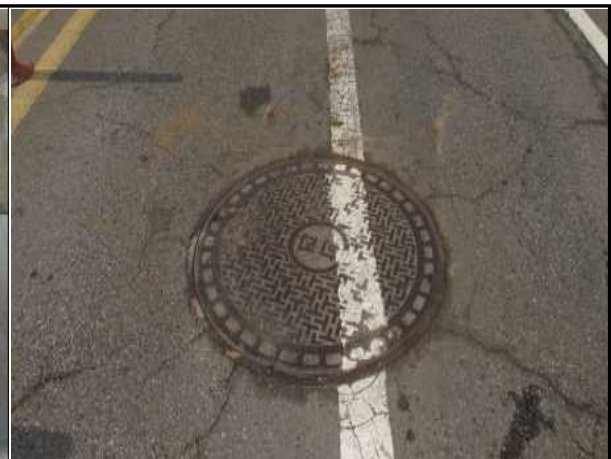
내용 도로포장 아스콘망상균열
