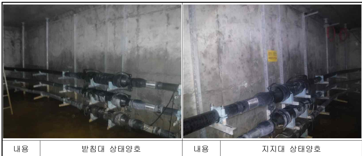
【사진 11.48】 부속 및 부대설비 현황
