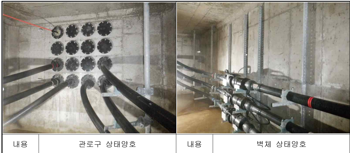
【사진 11.70】 맨홀 내부 주요 손상
