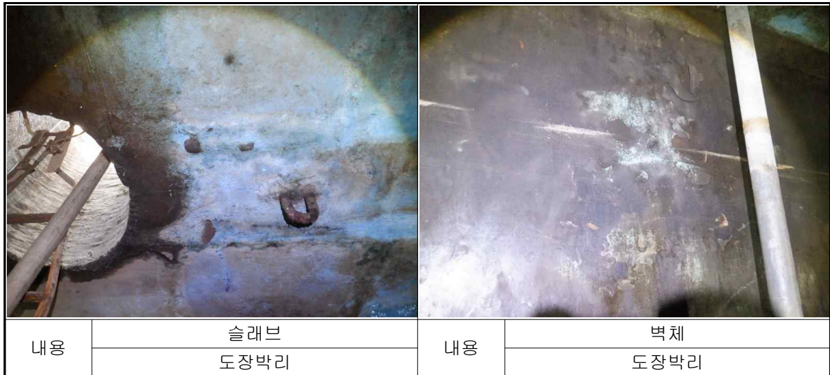
【사진 11.6】 맨홀 내부 주요 손상
