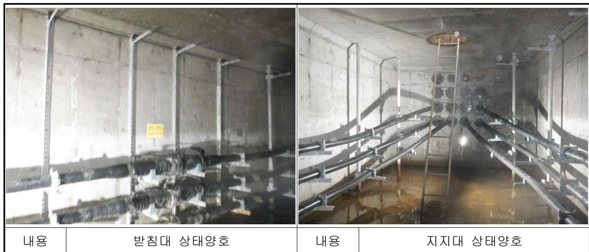
【사진 11.44】 부속 및 부대설비 현황
