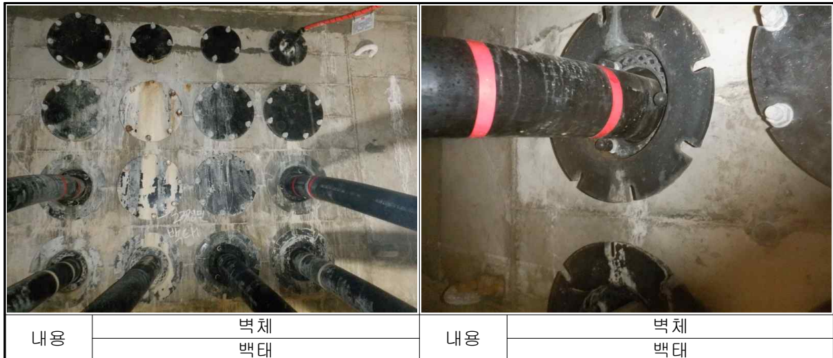
【사진 11.30】 맨홀 내부 주요 손상
