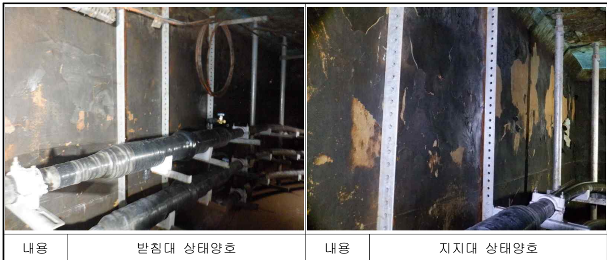
【사진 11.12】 부속 및 부대설비 현황
