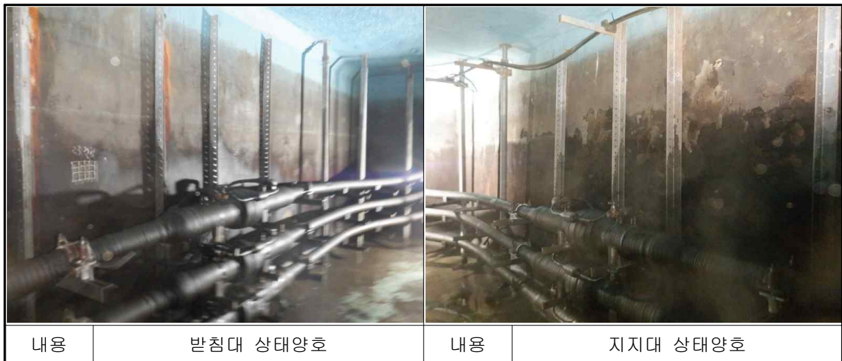
【사진 11.20】 부속 및 부대설비 현황
