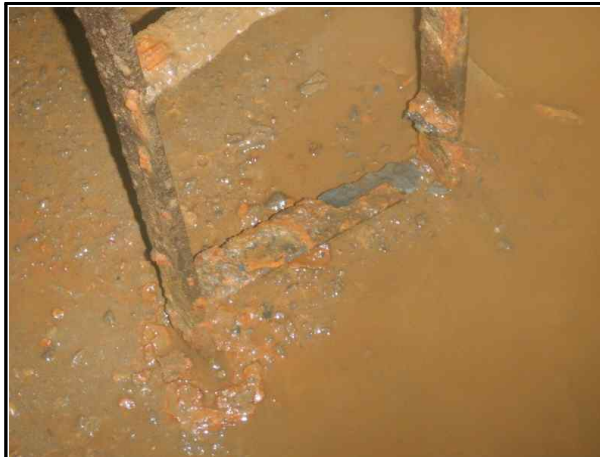
내용 추락방지시설 사다리 하부 고정불량
