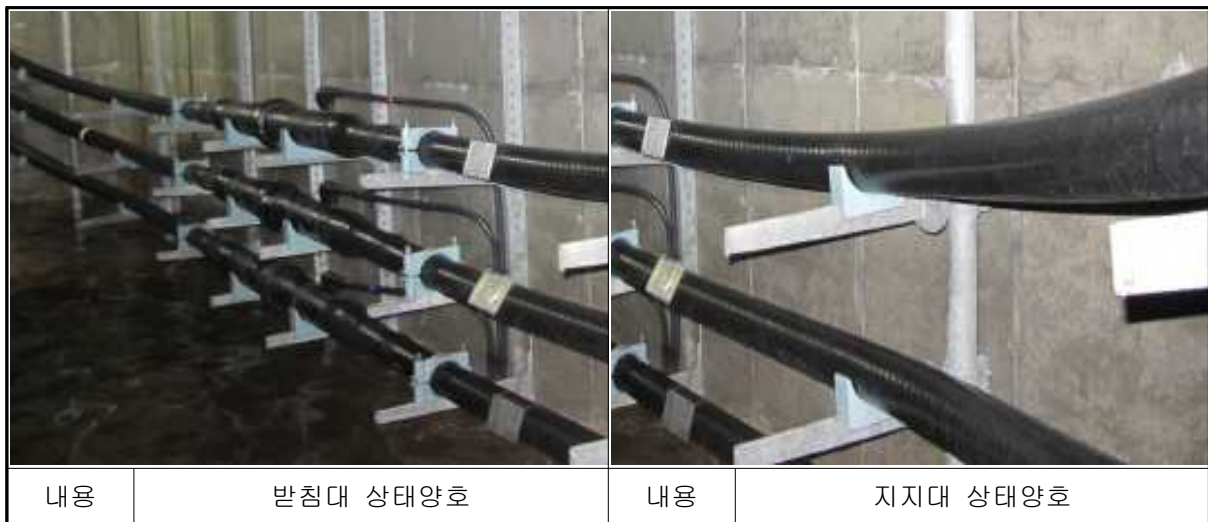
【사진 11.40】 부속 및 부대설비 현황
