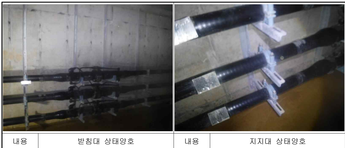
【사진 11.36】 부속 및 부대설비 현황
